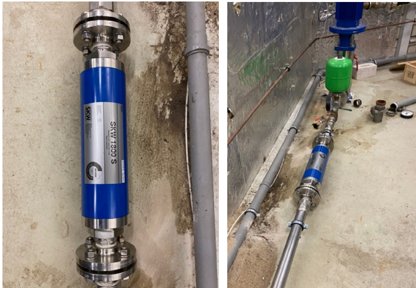
Beispiel der SKW-Anlage (Installation in Mönchengladbach im unmittelbaren Anschluss an den Wasser-Hauptanschluss des Stadions, welcher u. a. die Beregnungsanlagen erschließt)
